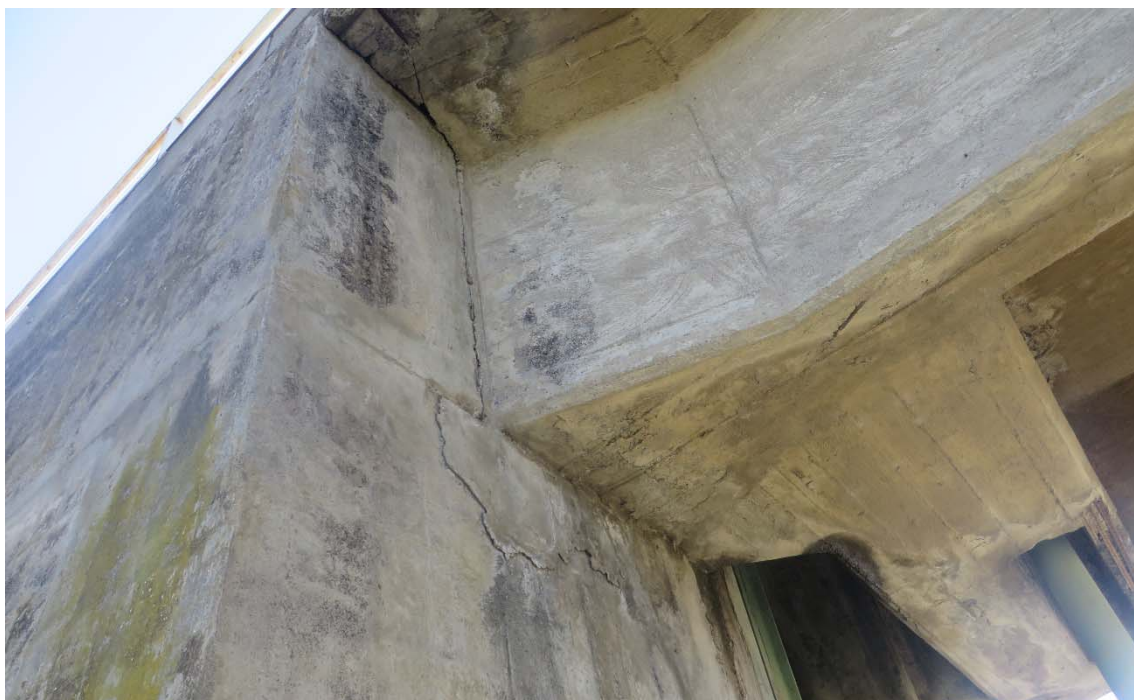
Foto 8: Particolare stato calcestruzzo armato.
