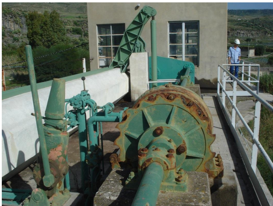
Foto 5: Sistema di manovra paratoia piana.
