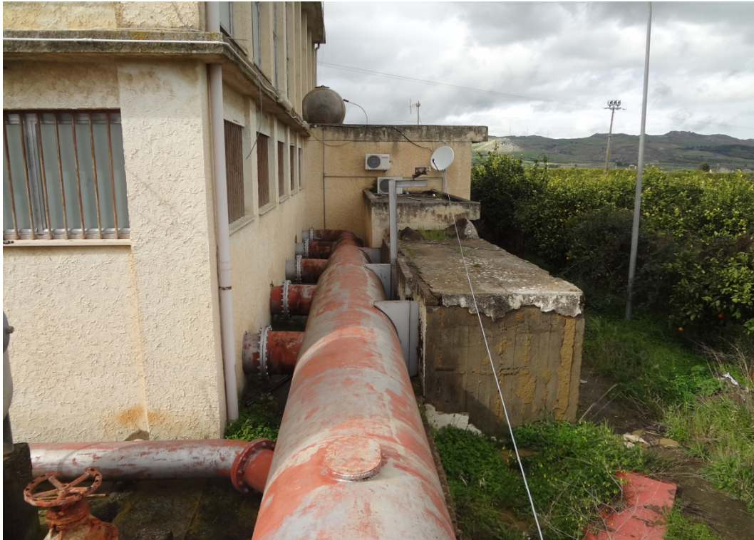
Vista di apparecchiature idrauliche di derivazione presso centro di controllo e misure
